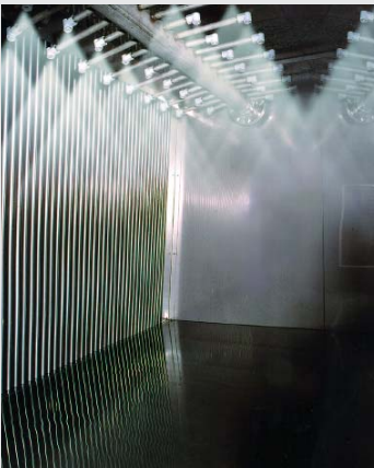
写真-3 空調機内部水シャワー冷却状況
