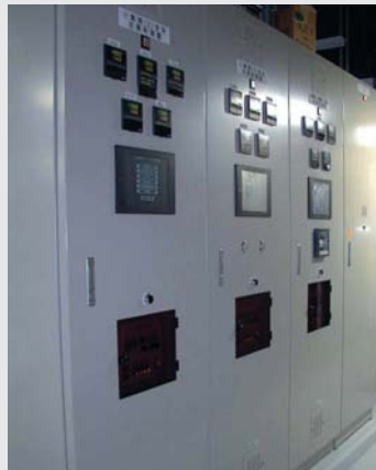
写真-4 空調設備動力&操作盤
