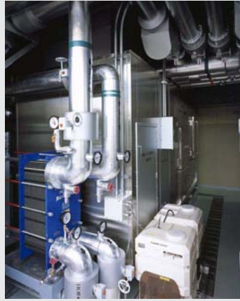
写真-2 空調和機廻り設備機器
