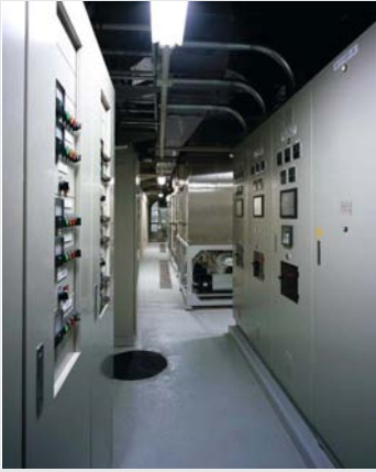
写真-1 機械室内機設置全体図
