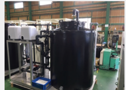
Fig. 5 実験動物飼育設備用の大型設備
