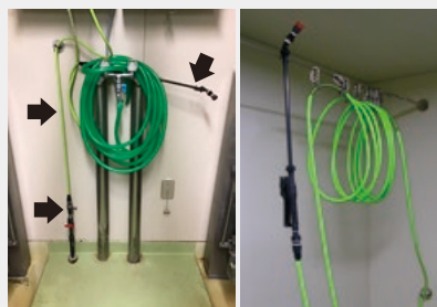
写真2-1：飼育室内に配管された消毒を行うための噴霧用ノズル(矢印)。 写真2-2：噴霧用ノズルに連続したカーテンレール。
