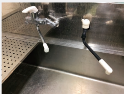
写真7：処置器材などを洗浄するためのシンクでの蛇口、左は上水蛇口。スーパー次亜水は黒いプラスチック製配管なので、上水配管とは目視で区別できる。
