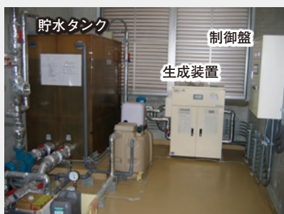
写真1：スーパー次亜水の生成装置と貯水タンク。
