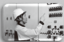
設備運転保守業務
